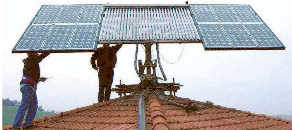
ENERGIA PULITA Pannelli fotovoltaici installati sul tetto di un condominio (foto Corelli)
